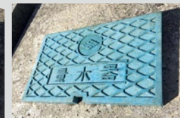
水道メーターの蓋
